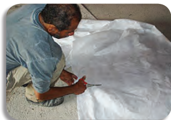
Limpeza da área e corte do Bidim VP na dimensão necessária. Limpieza del área y cortar Bidim VP en el tamaño requerido.
